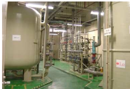
Local scrubber 廢水獨立回收
